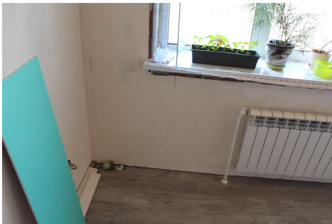
Фото 12. Локальное разрушение отделочного слоя наружного слоя стены
