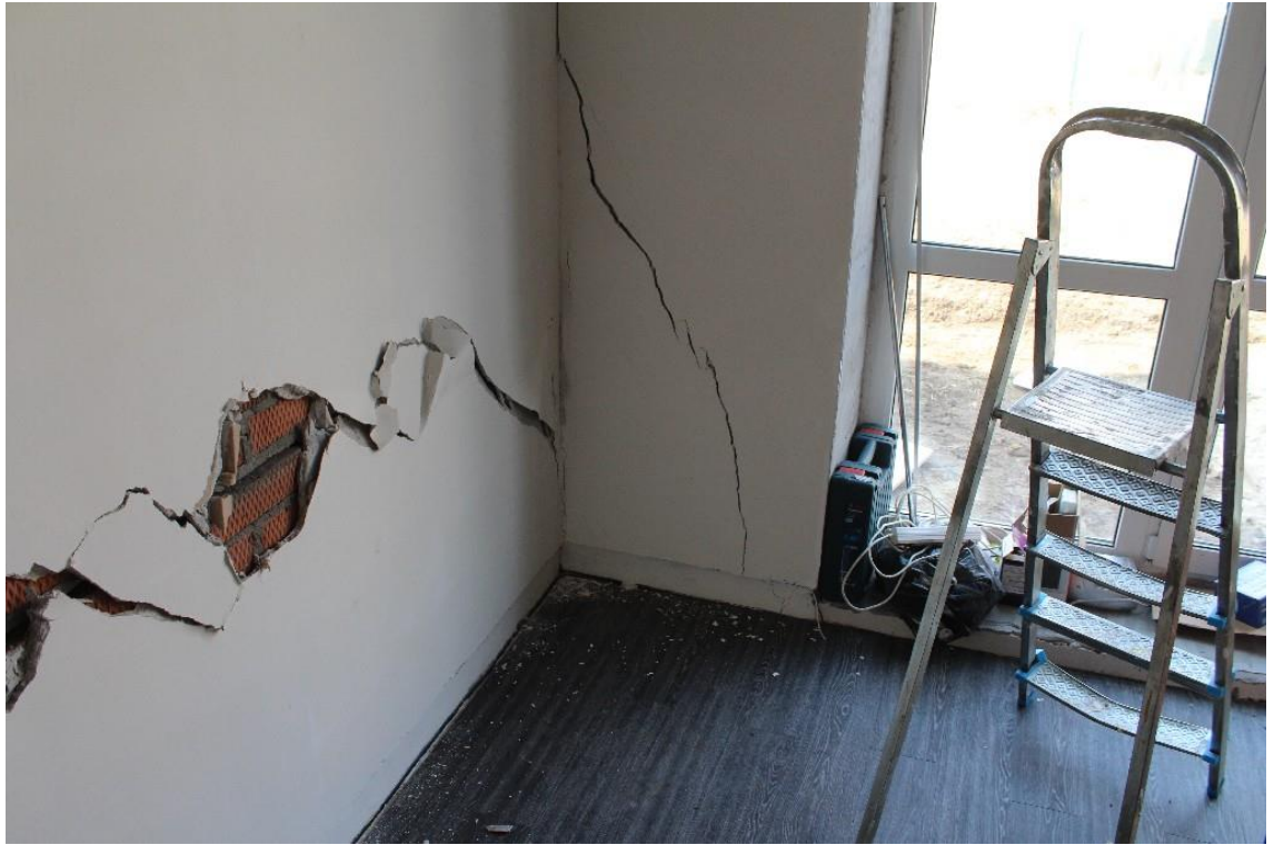
Фото 5. Локальное разрушение отделки наружной стены из гипсокартона
