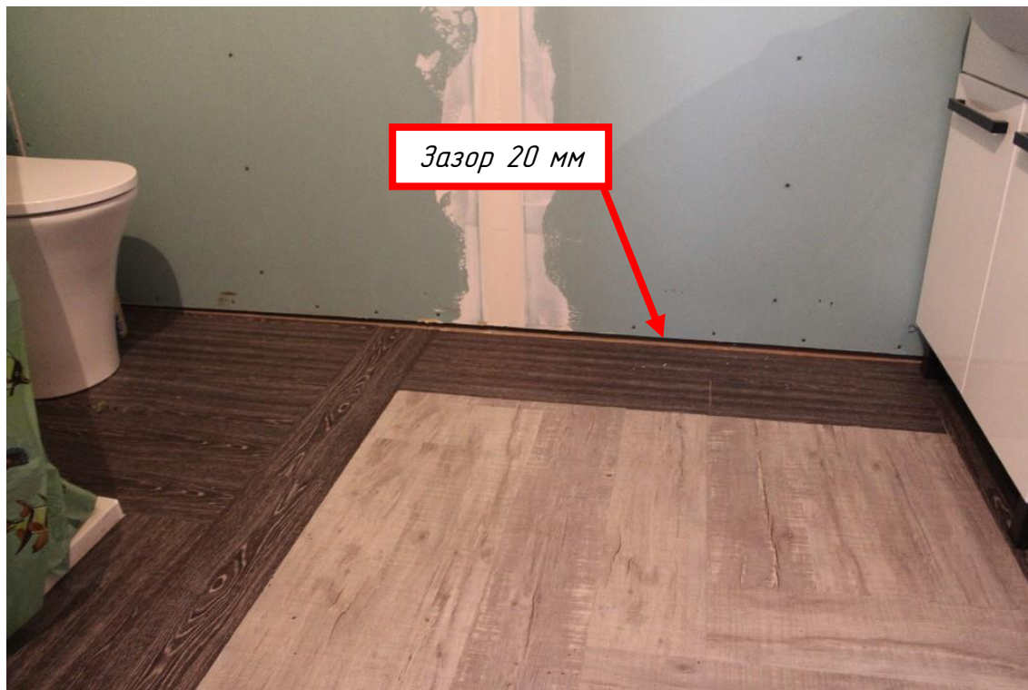
Фото 11. Зазор между отделочным покрытием пола и стены 20 мм
