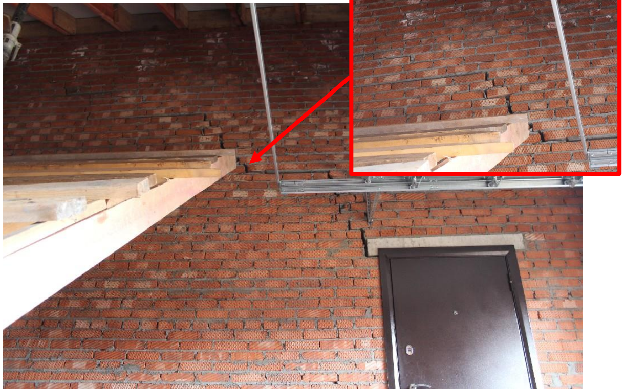
Фото 13. Трещина по кладке несущей стены по оси 2 (со стороны гаража)
