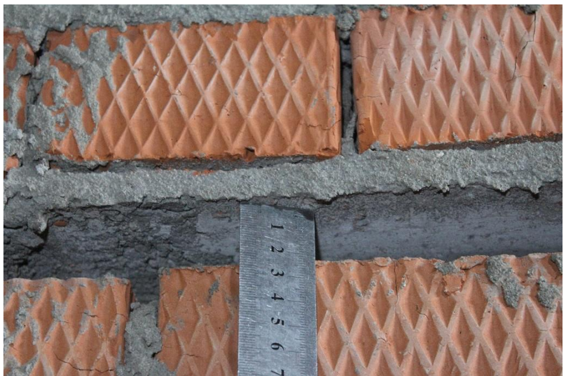
Фото 16. Ширина раскрытия горизонтальной трещины 23 мм.
