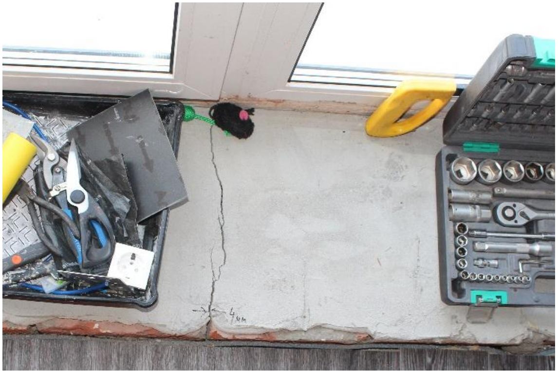
Фото 7. Трещина по кирпичной кладке, шириной раскрытия 4 мм под оконным проемом в осях Д/2-3
