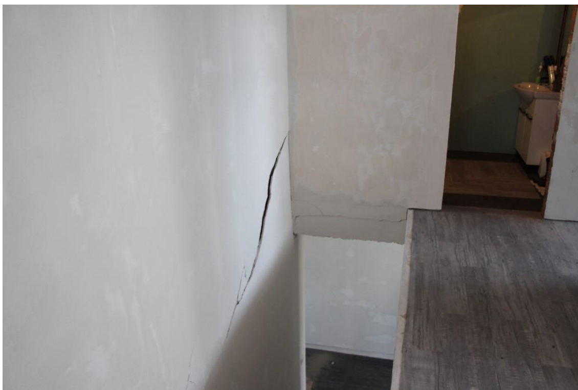
Фото 10. Локальное разрушение отделочного слоя перегородки
