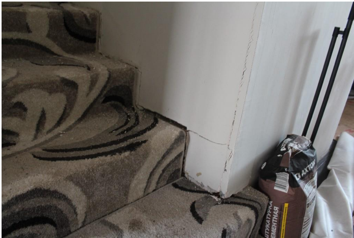
Фото 9. Локальное разрушение отделочного слоя перегородки
