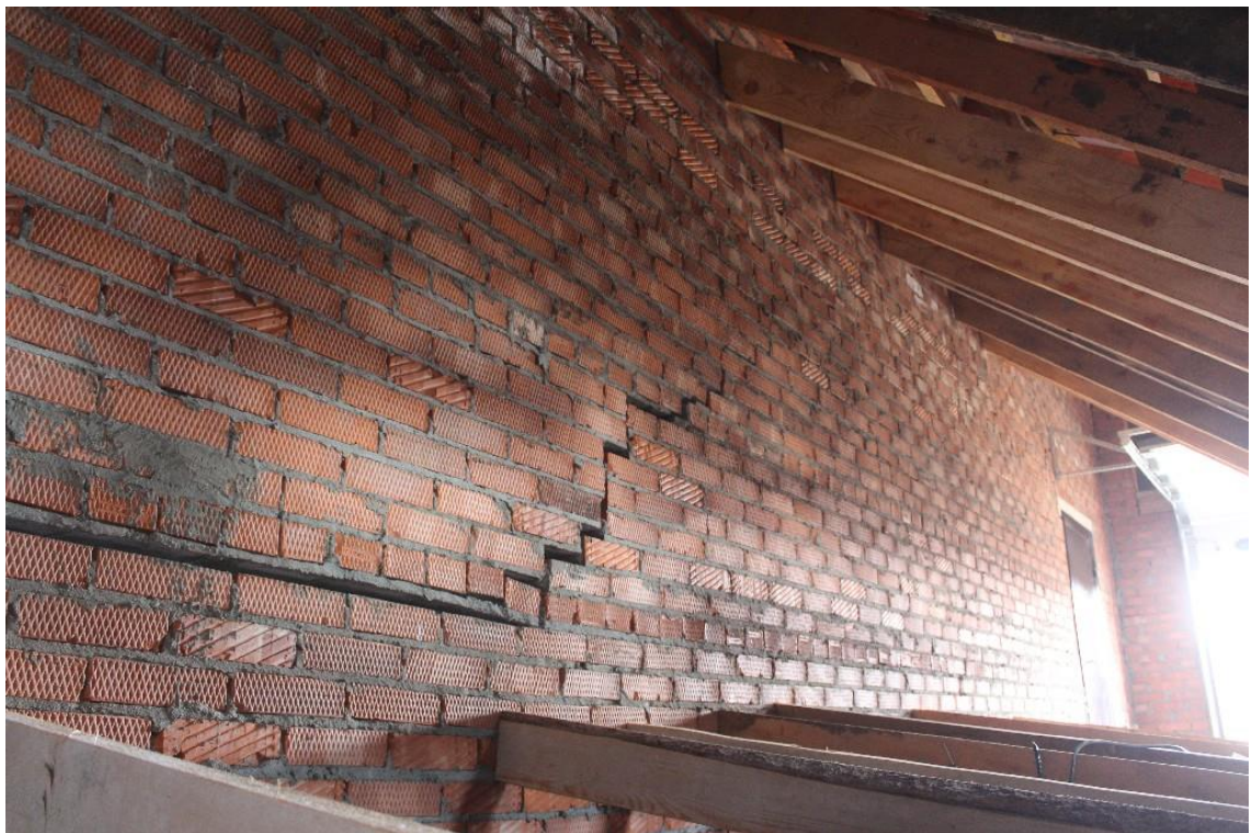
Фото 14. Трещина по кладке несущей стены по оси 2 (со стороны гаража)
