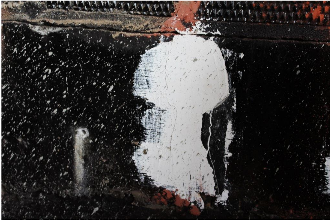
Фото 17. Трещина в ленточном фундаменте по оси 2
