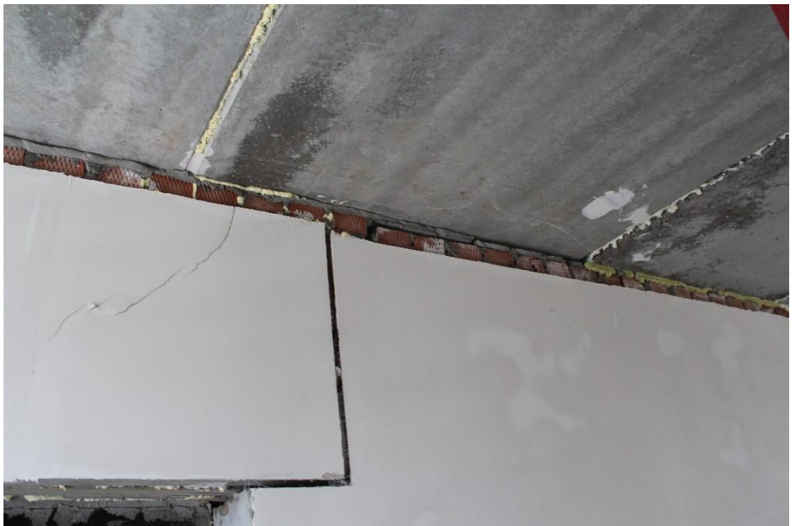
Фото 8. Локальное разрушение отделочного слоя стены, осадка кирпичной стены у опорной части перекрытия
