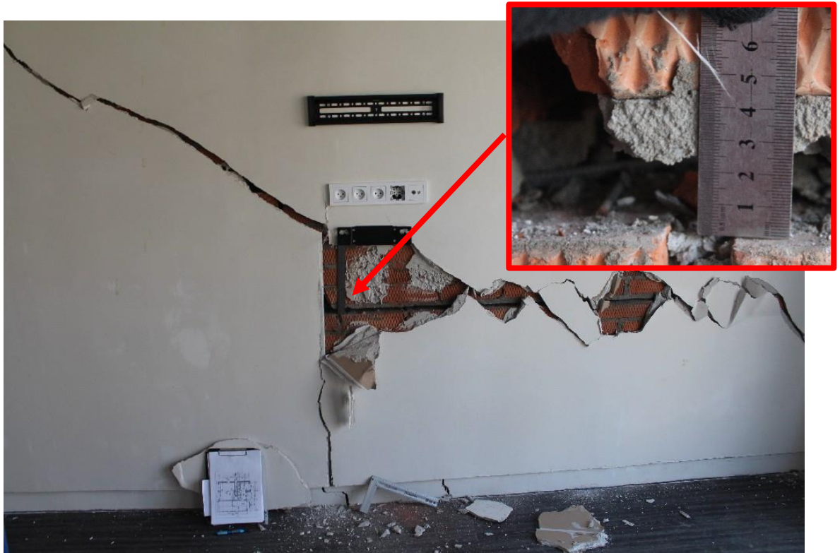
Фото 4. Трещина по несущей стене по оси 2, локальное разрушение отделочного слоя стены
